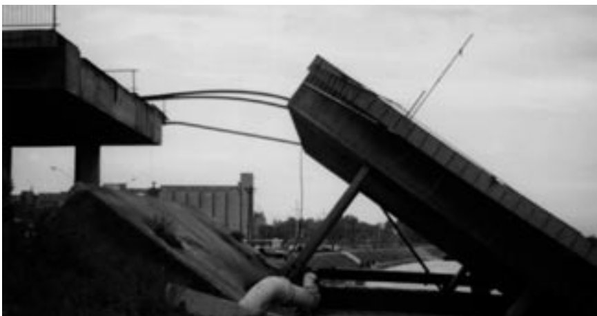
Zerstörte Betonbrücke - Novi Sad 2001
